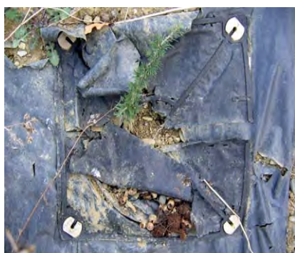
Photo 41 : Dégradation de la collettere Biofilm Sylva (18 mois)
