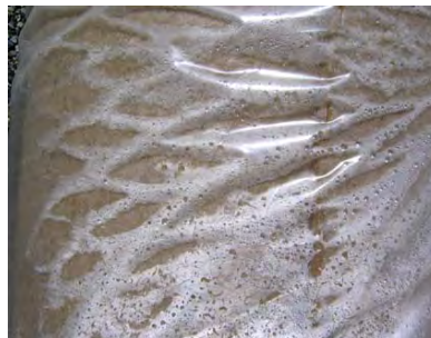
Photo 17 : Condensation d'eau sous l'emballage d'un feutre avant pose
