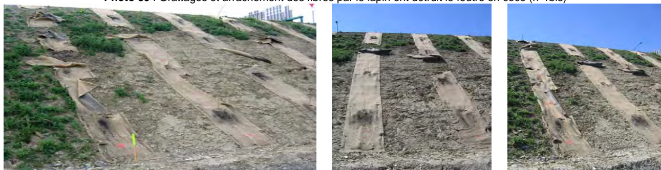
Photo 40 : Arrachement par le vent du paillis FCJ Bio 1000, 2 semaines après sa pose
